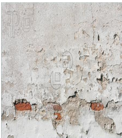
Fig: Flaking & Peeling
