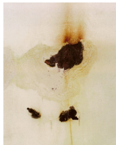
Fig: Rust Stains
